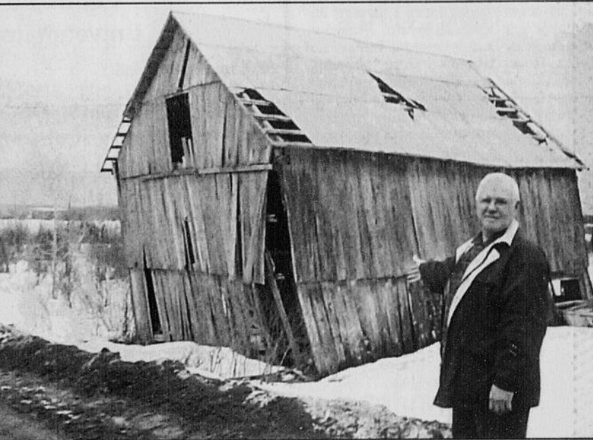
Photo La Tribune, Josianne Lussier André Bouthillier, citoyen de Saint-Gérard et également conseiller spécial en stratégie de mesures d'urgence, presse la municipalité de Beaulac-Garthby d'agir avant que survienne un accident causé par l'effondrement de cette grange désaffectée tout près d'une route, aux limites de la ville.
