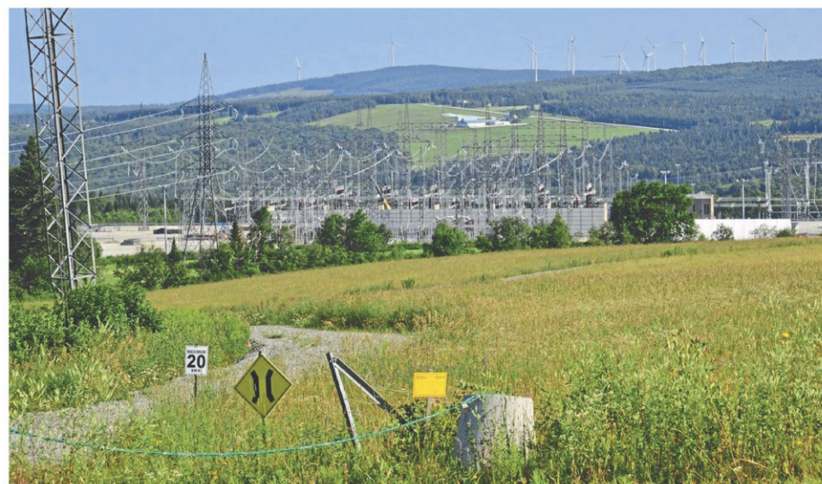
Le poste de Saint-Adrien-d'Irlande accueillera la nouvelle ligne de transport d'électricité. (Photo Courrier Frontenac - Jean-Hugo Savard)
