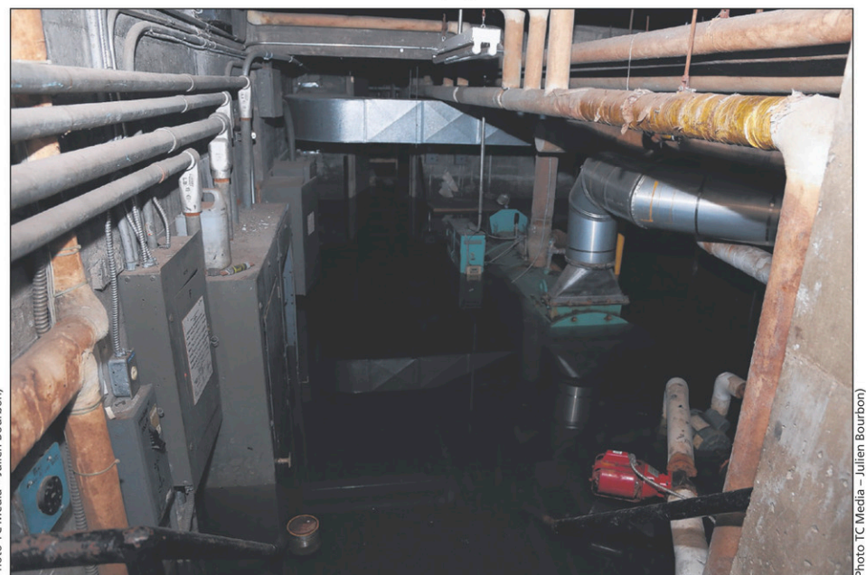
La chaufferie a été inondée au cours de la dernière année.
