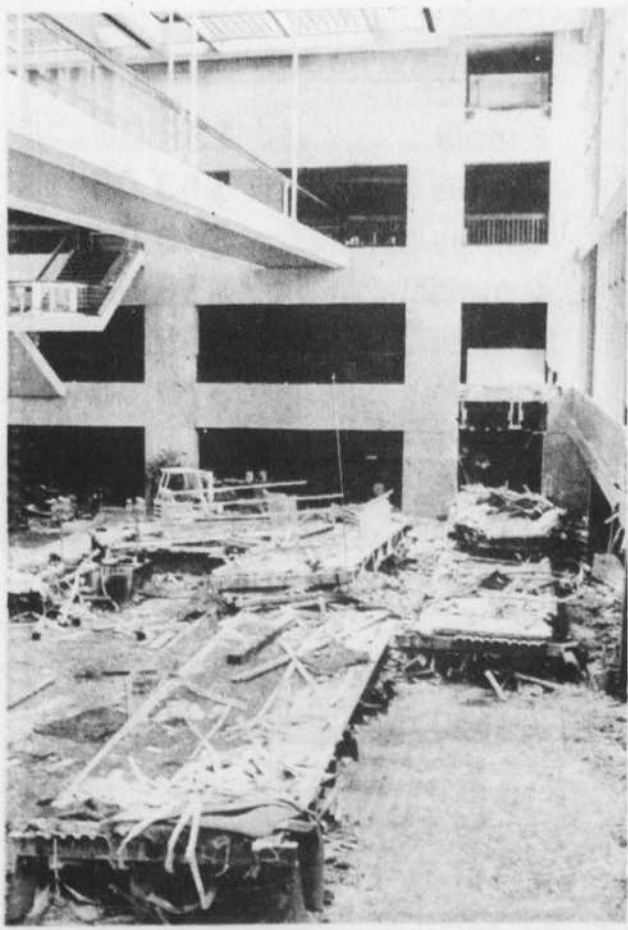
Voici l'aspect que présente le hall de l'hôtel Hyatt Regency, à Kansas City, après l'effondrement de deux passerelles qui a fait 111 morts et 188 blessés vendredi soir. (Photolaser AP)
