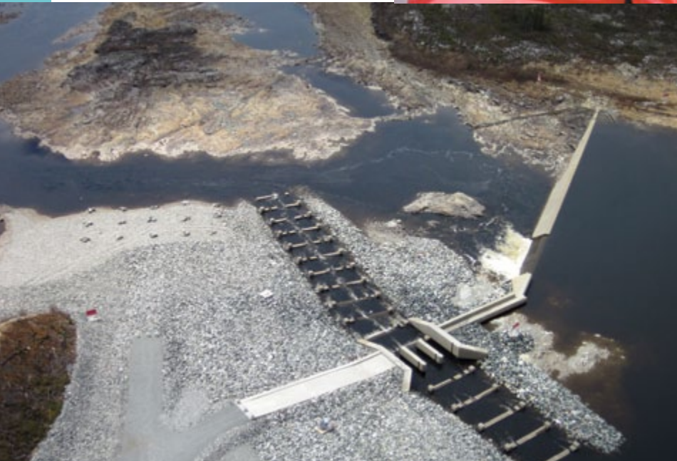
Passe migratoire aménagée au PK 207 de l'Eastmain (vue vers l'aval)
