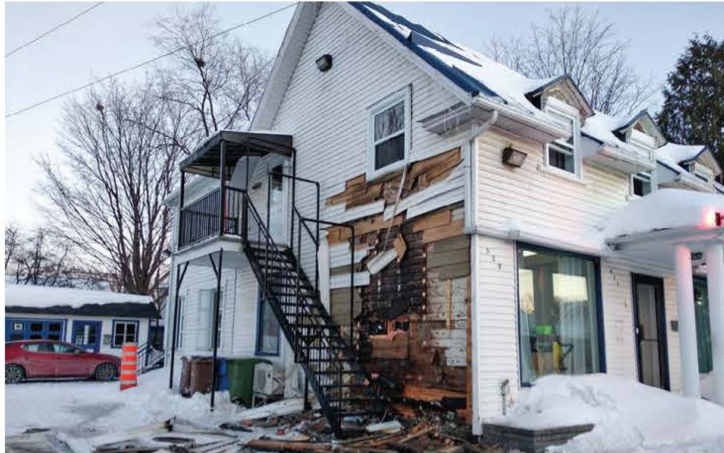
Un mur extérieur a été abîmé par les flammes.
