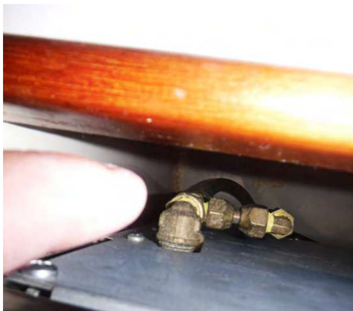
T de dérivation dans la cabine non-conforme.
