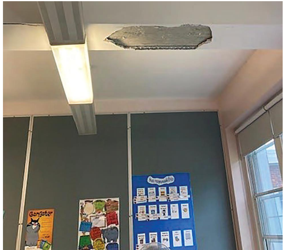
Un bout de plafond est tombé dans une classe de l'école De Montarville. (Photo : courtoisie)
