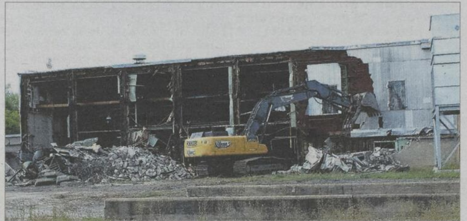
La Ville de Huntingdon a entrepris la démolition d'une section de l'ancienne usine Cleyn & Tinker située sur la route 202, le mercredi 3 septembre. Cette section, contaminée depuis des décennies, avait besoin d'être démolie. PHOTO TC MEDIA CHANTAL HORTOP
