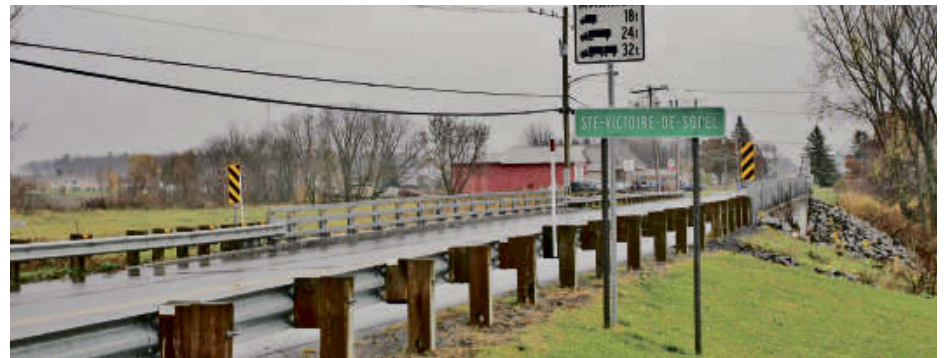
La limitation de poids sur le ponceau de la route 239, à Sainte-Victoire-de-Sorel, devrait cesser après les prochains travaux. Photothèque | Les 2 Rives ©
