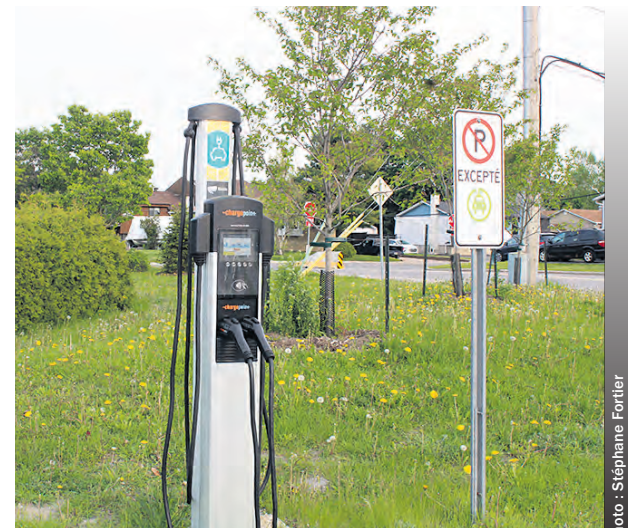
Deux bornes de recharge à courant continu (BRCC) seront installées à Mascouche.
