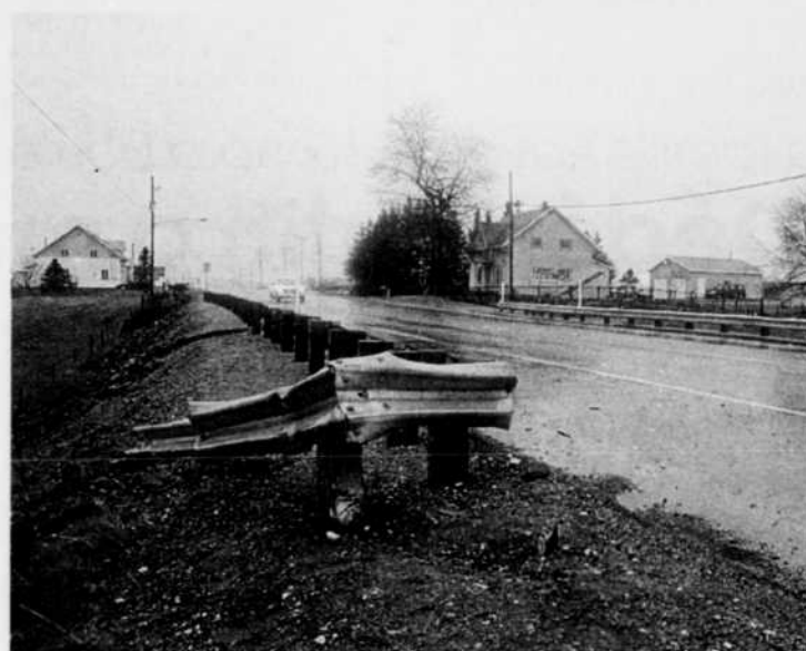
TORDU - La voiture a arraché les trois premiers poteaux du garde-fou avant de dévaler jusqu'au fond du ravin.
