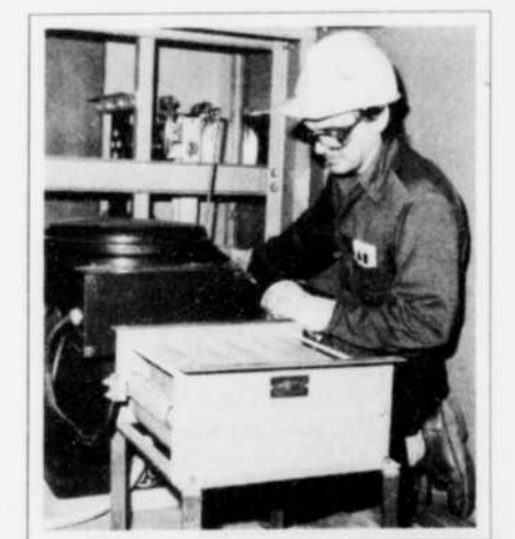
Certaines dispositions pour empêcher les écoulements de BPC sont peu apparentes. C'est le cas des plateaux de récupération, en blanc, à gauche de la photo, qu'on installe sous les équipements.
