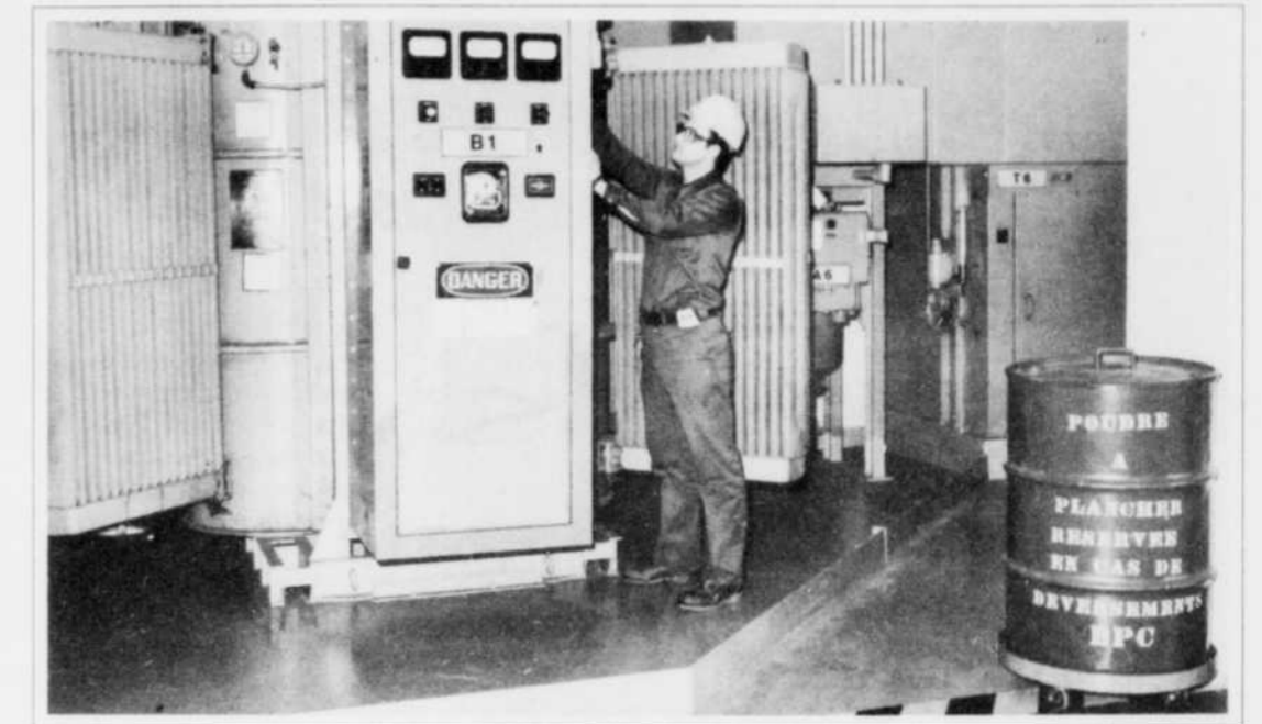
L'inscription, sur le baril, montre que les employés disposent du matériel nécessaire pour contrôler efficacement les fuites éventuelles de BPC.
