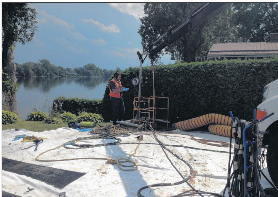
On ne le voit pas, mais le plongeur est au travail dans le trou d'homme pour y découper la plaque d'acier problématique. Une partie est néanmoins visible au sol.
