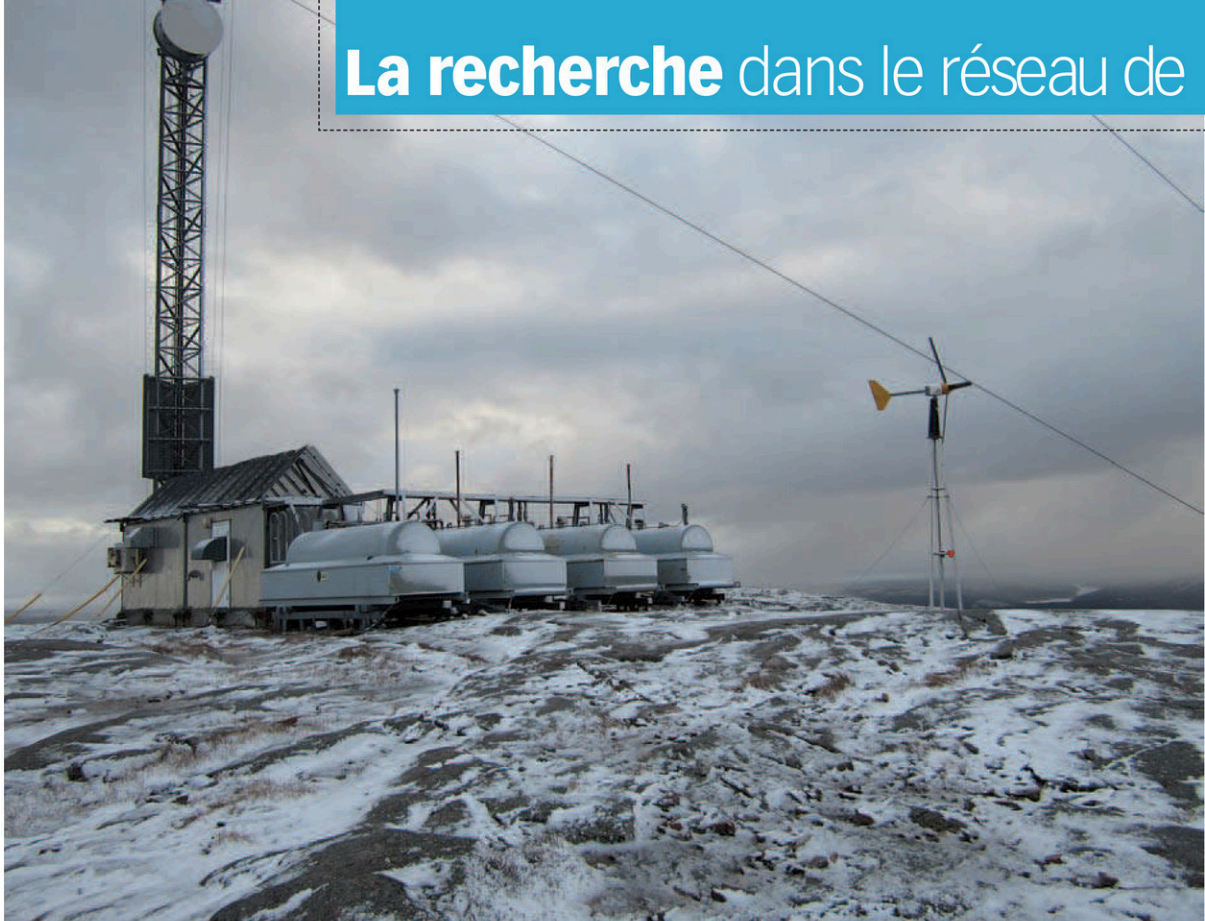
Une tour de télécommunication en Haute-Gaspésie équipée d'une combinaison génératrice au diesel et éolienne pour réduire la consommation de carburant fossile.
