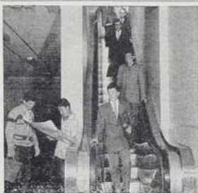
Trois Escaliers Roulants Turnbull à l'Ecole Polytechnique assurent le déplacement rapide du personnel et des étudiants de cette institution moderne d'enseignement.
