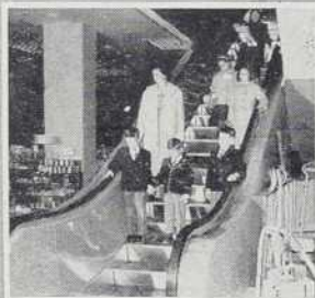
Une des nombreuses installations commerciales au Canada. Des Escaliers Roulants Turnbull procurent un service sans interruption entre les étages du magasin Simpson-Sears, Winnipeg.
