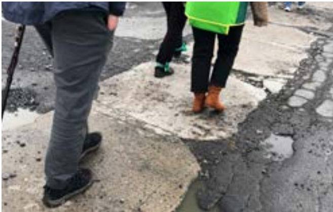
Fig. 6 - Irrégularités des trottoirs
