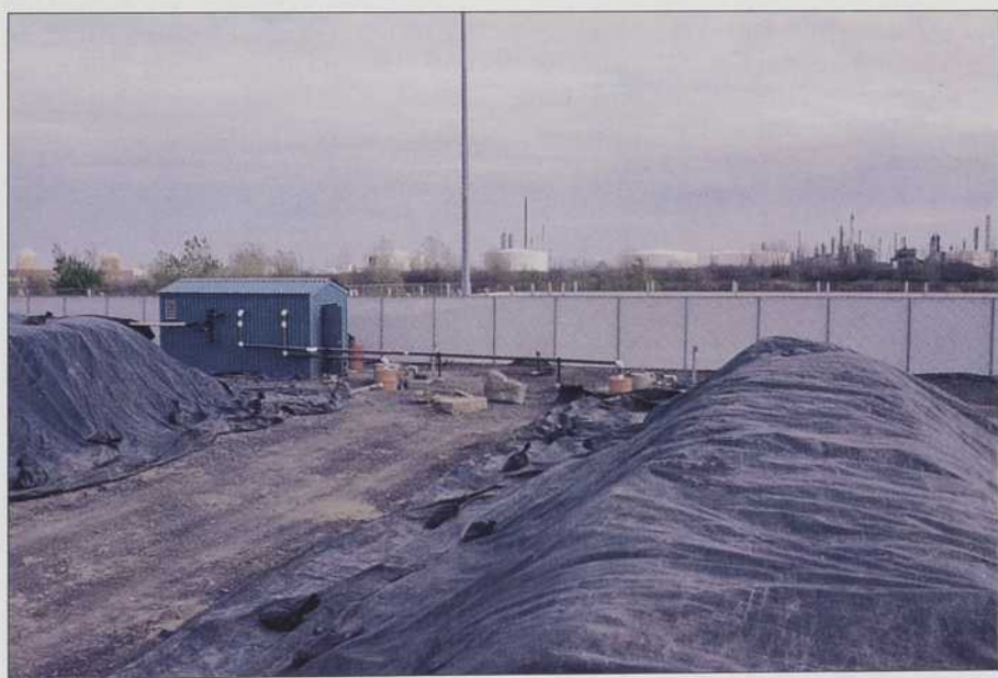
Le centre de traitement des sols Ultramar à Montréal-Est, conçu et opéré par Biogénie inc.
