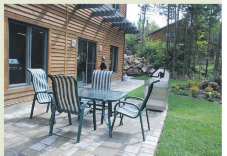
Trévi a fait don de la construction des patios, de l'escalier en pavé uni et du mur de soutènement en pierres de la Villa Mantha, un ouvrage complexe vu la pente du terrain.
