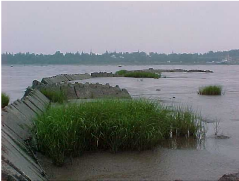
Figure 19. La construction de cages à sédiments, ici à Rivière-du-Loup, constitue une façon de lutter contre l'érosion tout en augmentant la superficie du haut-marais.
