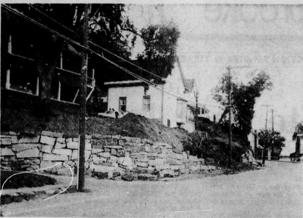
Les employés de la ville de Rock Island ont plus de la moitié du travail d'effectif à la réparation du mur de soutènement de la rue Railroad. Ce mur à la suite de la venue du printemps menaçait de s'écrouler. Les autorités de la ville économiseront quelques milliers de dollars en faisant faire ces travaux par leurs employés qui semblent être experts dans la matière.
