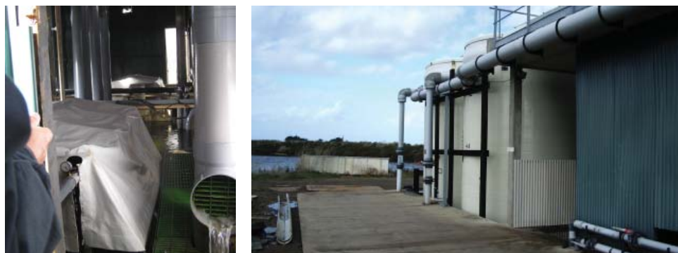
Filtre à tambour d'une des sections et tours de biofiltration situés à l'extérieur
