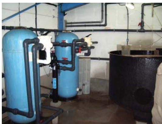
Deux cylindres de biofiltration avec des argiles expansées
