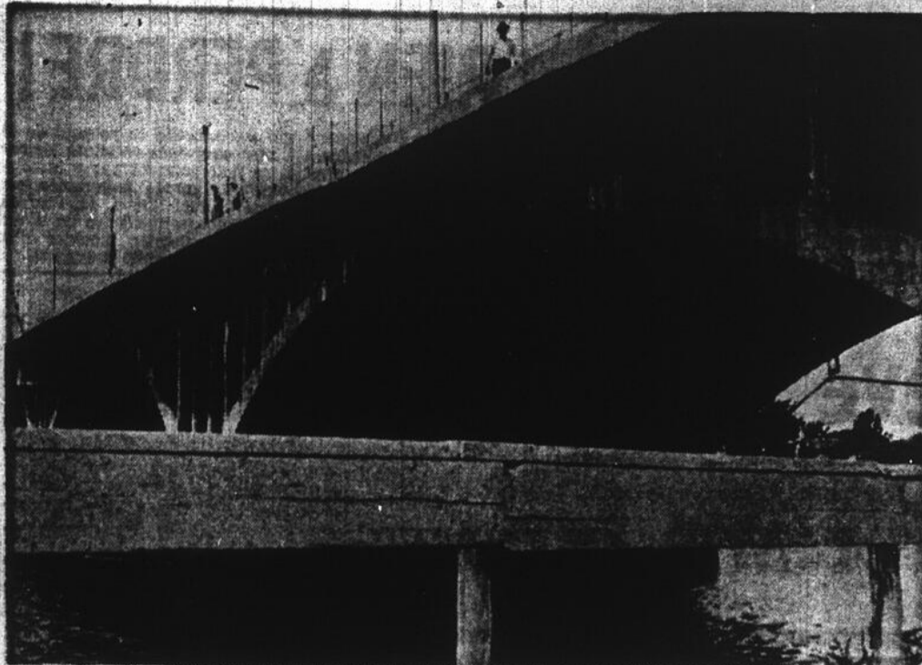
DES ENNUIS TEMPORAIRES — Pour quelques semaines à venir, les automobilistes qui, par milliers, empruntent chaque jour le pont Viau auront l'occasion de tempêter. La circulation se fait, dans les deux directions, à voie simple. Les travaux de réfection, tant des garde-fou que du pavé s'imposent. (Photo Gilles Hayden)
