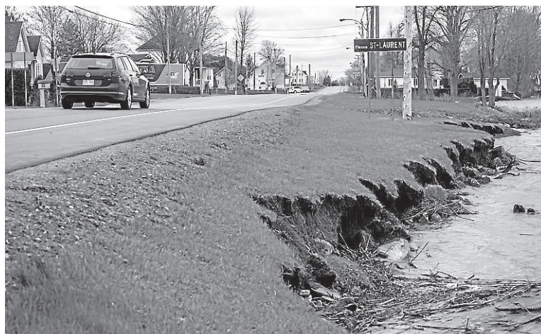
Cette érosion le long de la route 132 préoccupe le conseil municipal de Bécancour qui se penche sur d'éventuels travaux préventifs.
