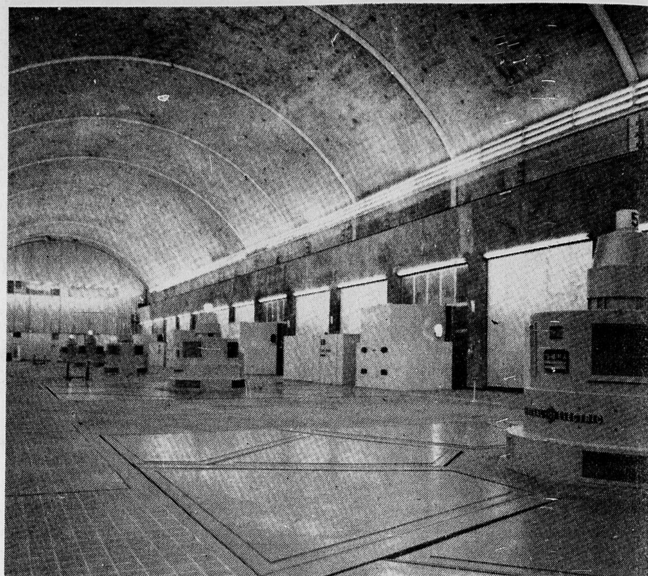
CENTRALE SOUTERRAINE — On voit ici l'intérieur de la centrale hydro-électrique de l'Alcan, à Chute-des-Passes.
