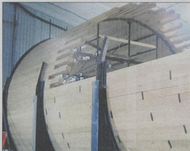
La conduite d'eau de la centrale Murdock Wilson est faite d'un assemblage de pièces de bois de 6X6 qui doivent se gorger d'eau pour être étanches.
