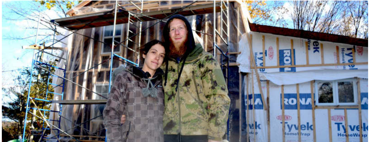
Émy Beauchemin et Pierre-Luc Chapdelaine, de Wickham, gardent le moral malgré le travail colossal que représente la reconstruction de leur maison à cause d'un taux élevé de moisissures.
