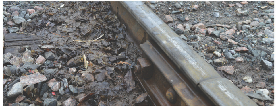
Des travaux seront réalisés dans les prochains mois pour changer des traverses et des rails et niveler le chemin de fer un peu partout en Outaouais. (Photo: L'Info de la Basse-Lièvre-Yannick Boursier)
