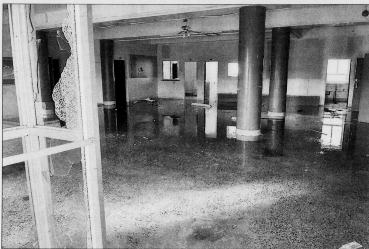
Des vandales ont saccagé l'ancienne école Saint-Michel, à Jonquière. L'eau recouvrait le sol sur chaque étage.
