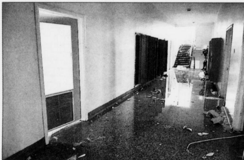
Les dommages sont évalués à plusieurs milliers de dollars.
