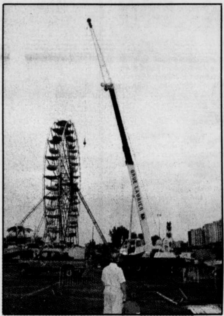
Hier midi, une grue mécanique géante était en place en vue de compléter les préparatifs pour le saut à élastique.
