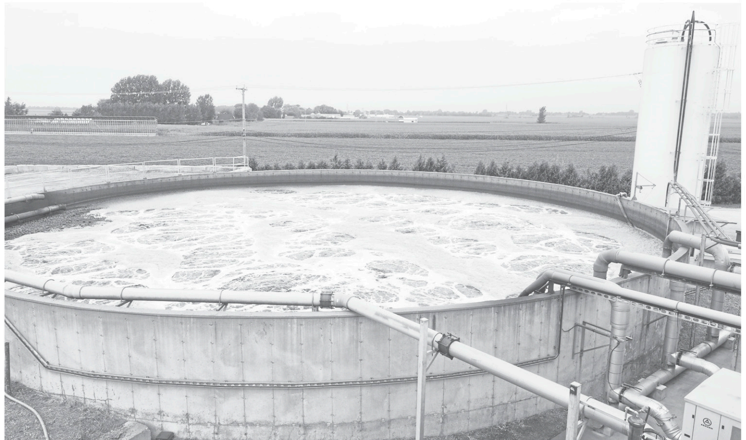
L'endroit dispose d'installations pour y effectuer du traitement d'eau. — PHOTOS ALAIN DION
