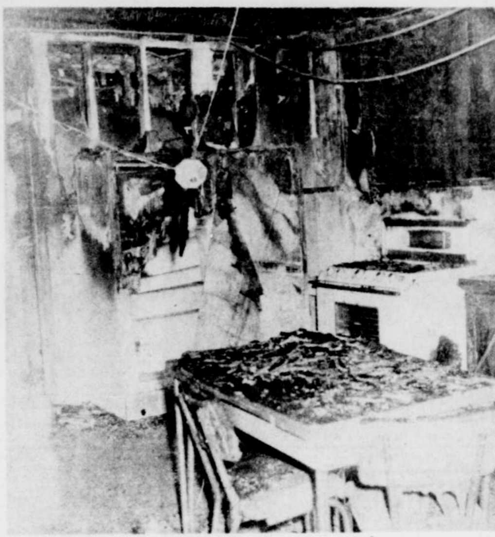
LE FEU A CAUSE des dommages considérables à la maison de M. Napoléon Boisvert, rue des Hétrés. Nous avons ici une bonne idée des débris qui jonchaient les lieux après la conflagration qui a nécessité l'intervention des pompiers des deux postes.
