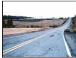
Figure 5 - Correction couche d'usure 1994 - Route 253, 1999 (5ans)
