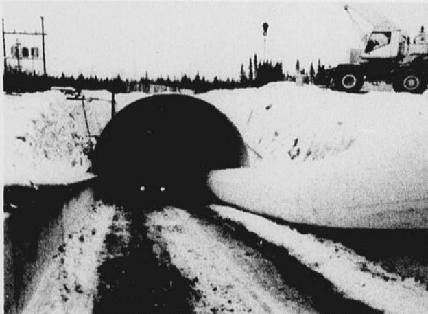
Depuis la mi-septembre 1987, 1,880 pieds de rampe ont été foncés et ont atteint les zones minéralisées dès la fin du mois de janvier.
