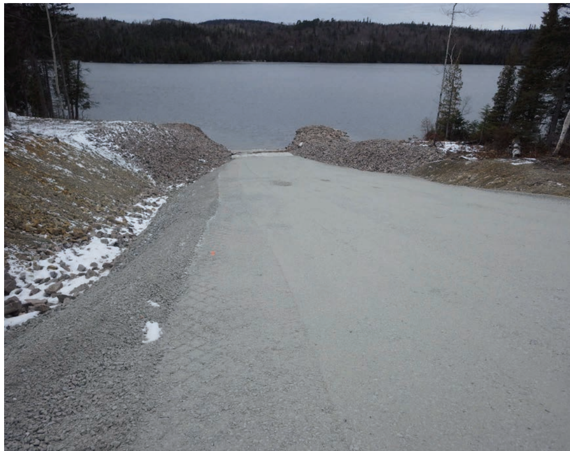
Une rampe de mise à l'eau a été installée pour l'accès au lac Gobeil ainsi qu'un nouveau stationnement. Photo courtoisie
