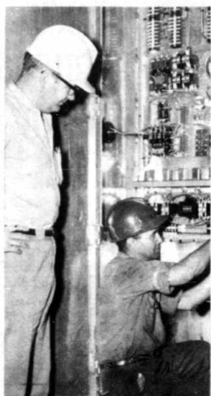
DERNIER AJUSTEMENT — Sous le regard de M. H. Payne, contremaître au Service de la distribution de l'énergie électrique, M. Camille Tremblay, électricien, met la dernière main à un des neuf redresseurs de courant au silicium de la station no 2.
