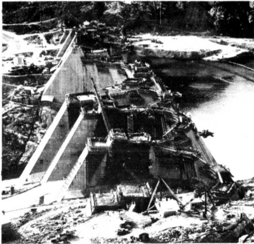
MANIC 5 — Même si le barrage de Manic 5 est loin d'être terminé, le niveau des eaux est déjà de quelque 250 pieds en amont de cette série de voutes en béton et de contreforts. Une fois le barrage et la centrale complétés, Manic 5 fournira 1,800,000 HP de puissance installée additionnelle à l'Hydro-Québec. La dernière phase des travaux est prévue pour 1972.
