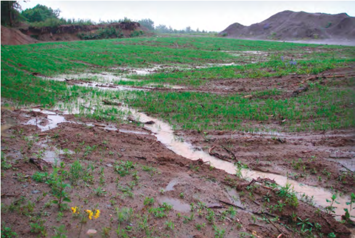
Photo 11 - Vue d'une surface réaménagée en train de s'éroder. Les pertes de sol arable sont importantes. À noter que le sol est excessivement compact.
