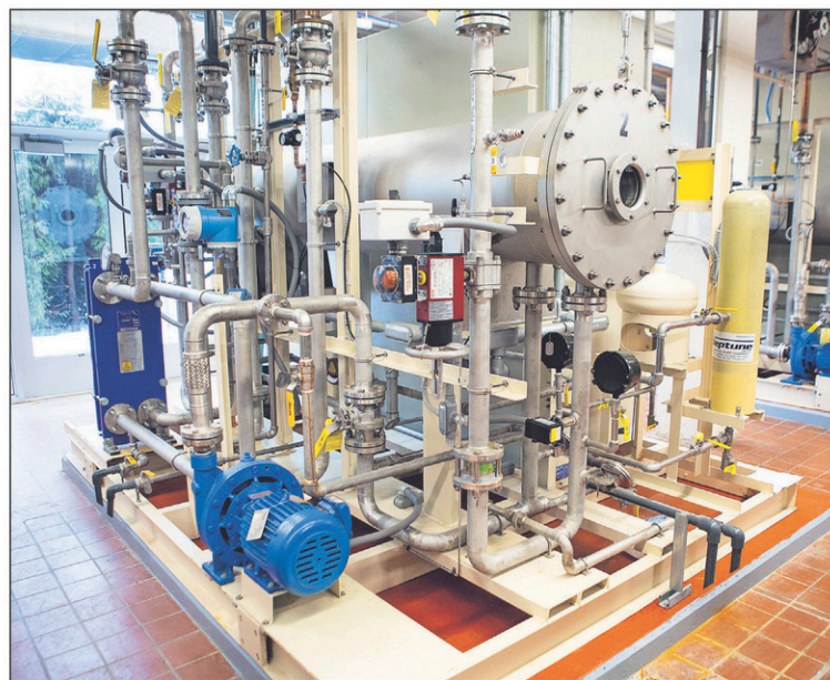
L'usine de filtration possède sa propre unité de fabrication d'ozone, un gaz 600 fois plus puissant que le chlore.
