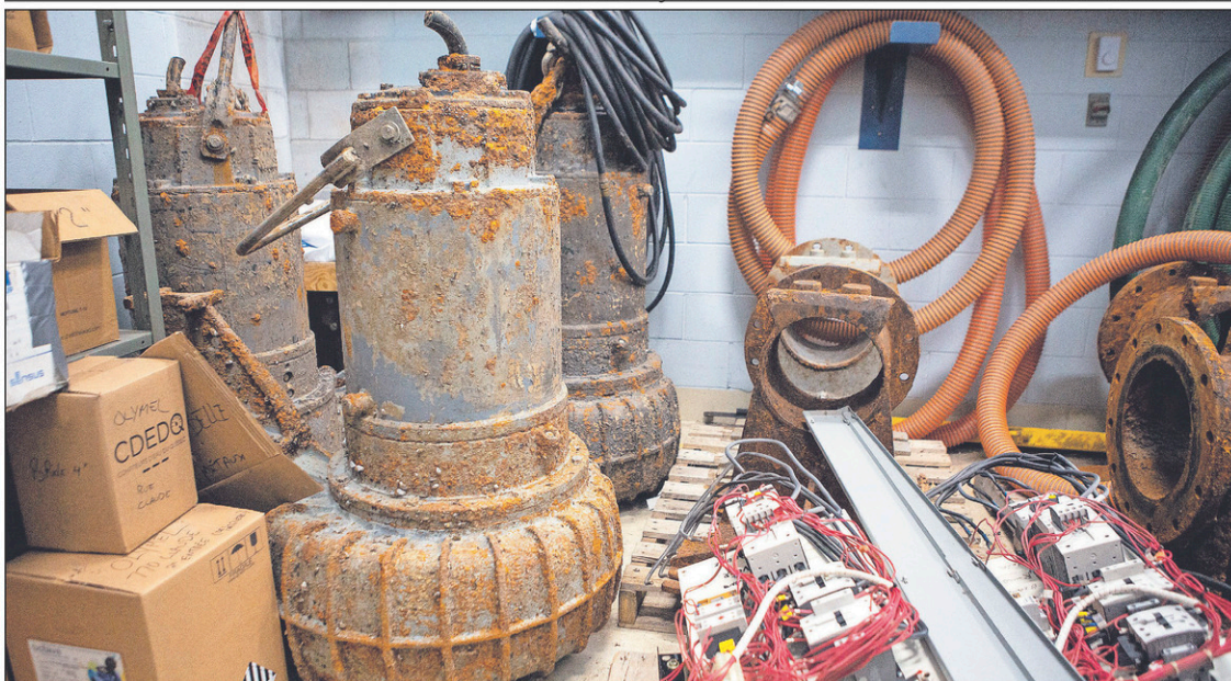
L'usine de filtration possède tout un arsenal de pompes submersibles. Elles seront fort utiles au moment de la réfection de ses réserves souterraines.
