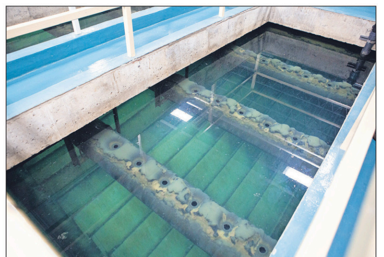
Les particules s'agglutinent en gros flocons autour des tuyaux du décanteur. Ce qu'on appelle le floc est retiré des bassins une fois par année.
