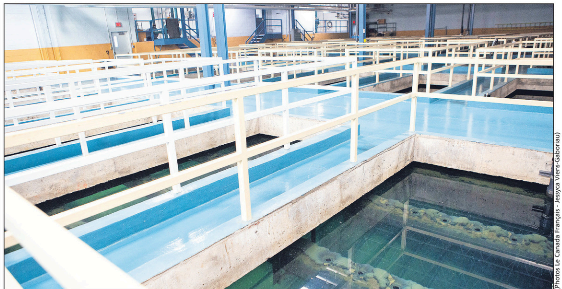
La décantation de l'eau brute permet d'intercepter 90% des particules en suspension provenant de la rivière.
