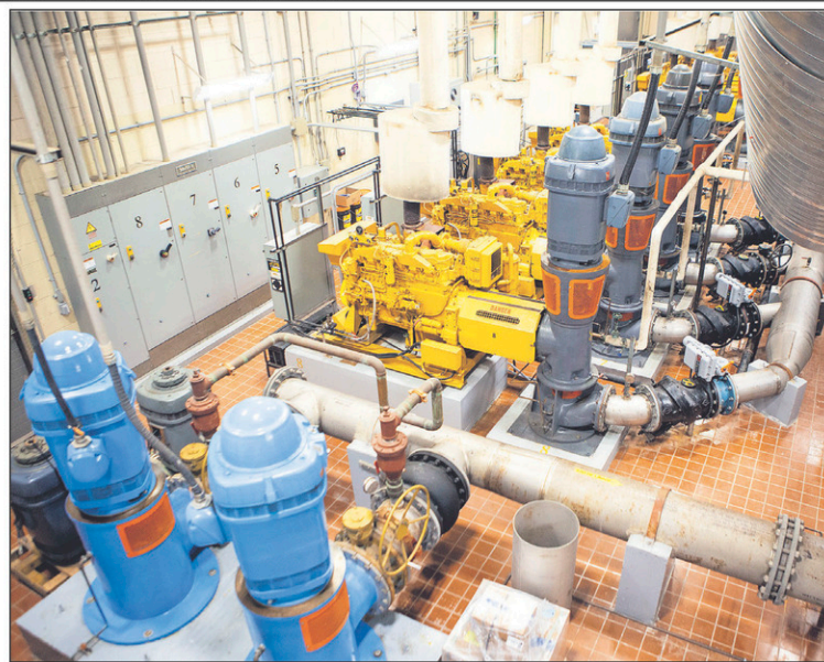
La vaste salle des machines comprend huit puissantes pompes pour distribuer l'eau potable dans le réseau d'aqueduc.
