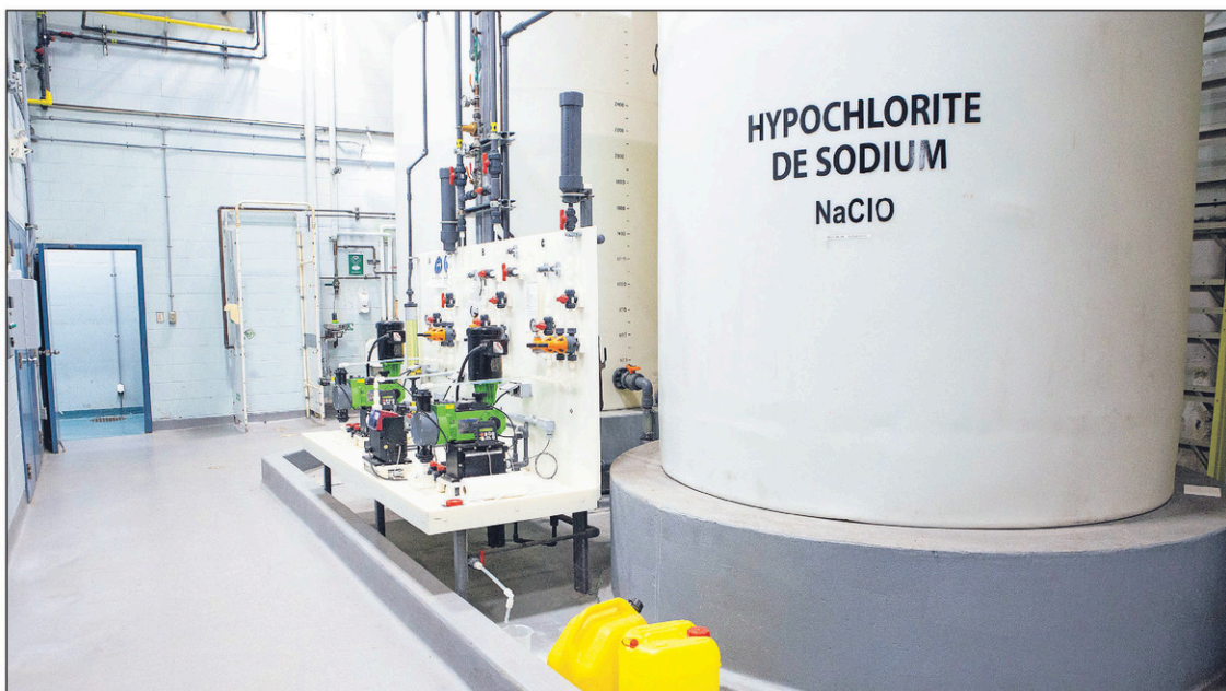
Le chlore est injecté dans l'eau à partir d'immenses réservoirs.
