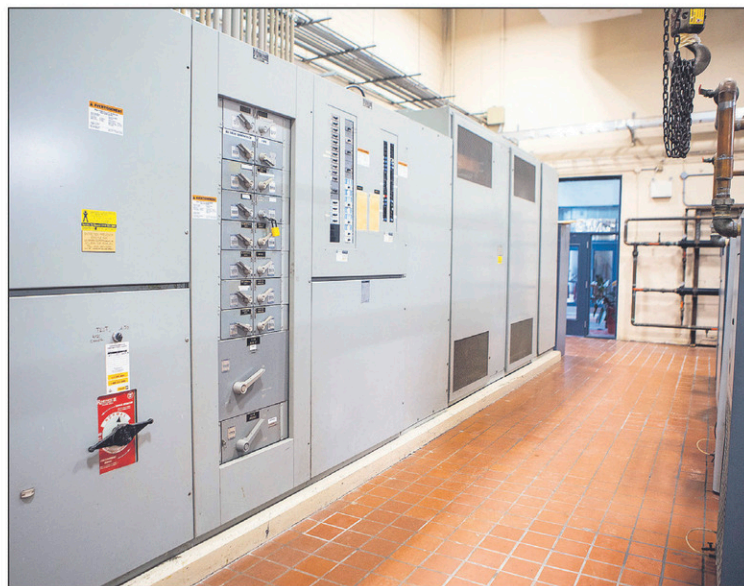
La chambre électrique témoigne de l'amplitude de courant réclamée pour faire fonctionner l'usine.
