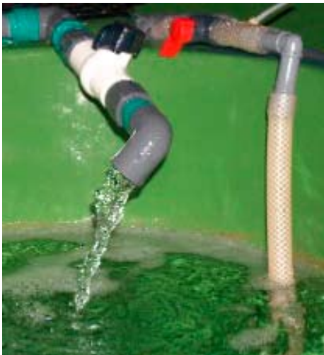
9. Valve d'alimentation en eau et en oxygène dissous à portée de main.
