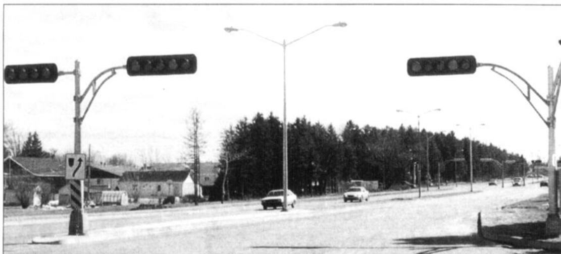
EXPÉRIENCE - L'administration municipale de Jonquière utilise à titre expérimental des feux de signalisation à diodes électroluminescentes. En en trouve à deux endroits dans la ville: près de la caserne de pompiers et à l'entrée du site de dépôt de neiges usées.
