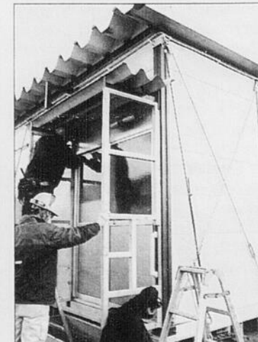
Des travailleurs construisent des résidences temporaires pour permettre aux sinistrés d'avoir un toit.
