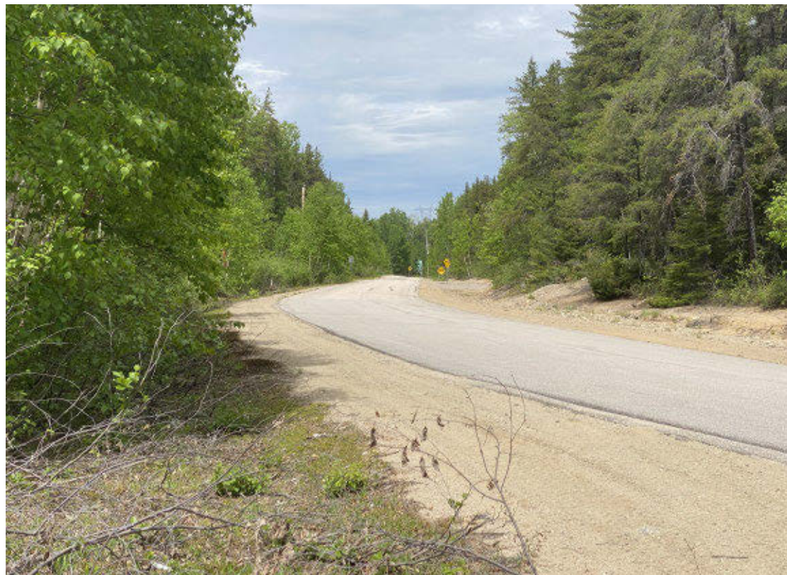
Le rang Paul-Baie, situé à Forestville, pourrait subir des réparations s'il est priorisé dans le cadre du Plan d'intervention en infrastructures routières locales (PIIRL) de la MRC de La Haute-Côte-Nord.
