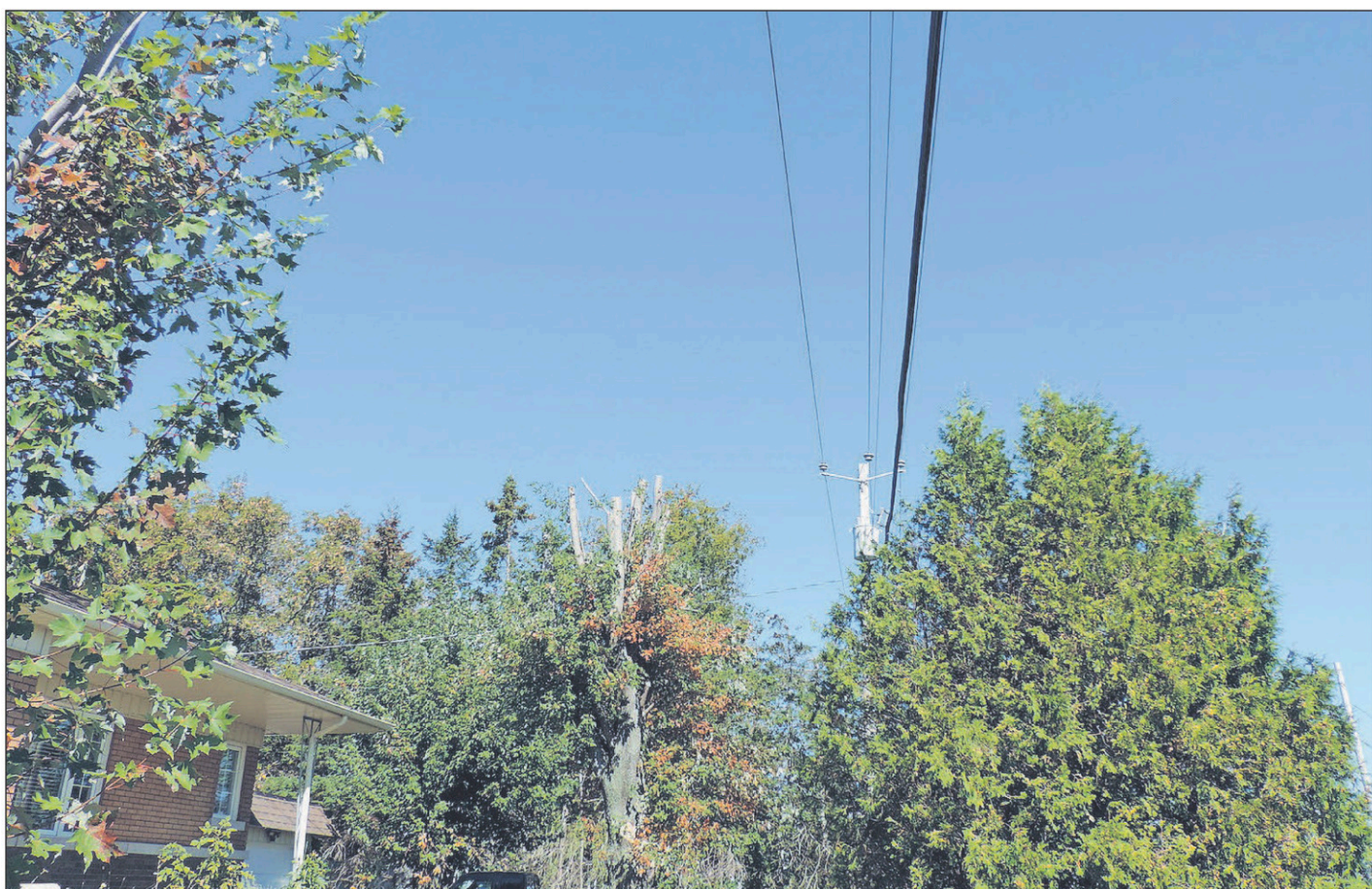
Mieux vaut se méfier des fils électriques pour éviter une grave électrocution comme celle survenue dans Lanaudière il y a quelques semaines.
