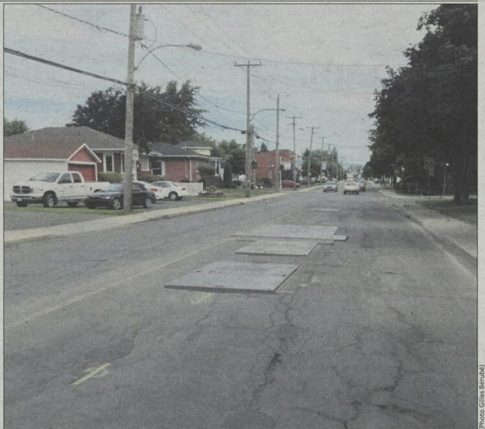
Les plaques d'acier qui recouvrent la chaussée du boulevard d'Iberville ont été mises en place par Gaz Métro.
