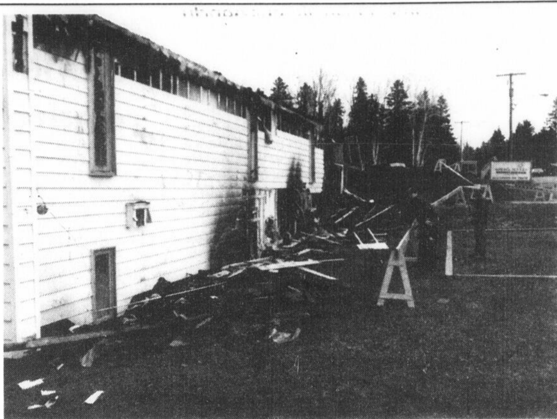
NETTOYAGE - Hier, des ouvriers s'affairaient à délimiter un périmètre avant d'entreprendre des travaux de nettoyage de ce qu'il reste sur le site de l'Auberge des îles de Saint-Gédéon. (Photo Steeve Tremblay)
