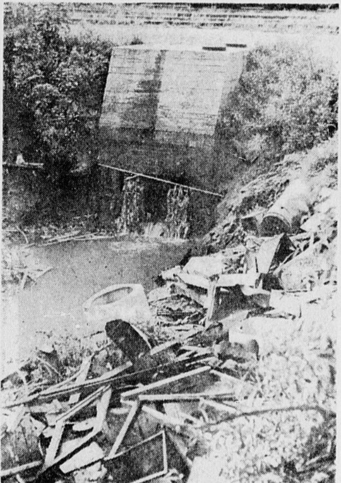
Il faut fermer ces bouches qui déversent des tonnes d'eau polluée.
