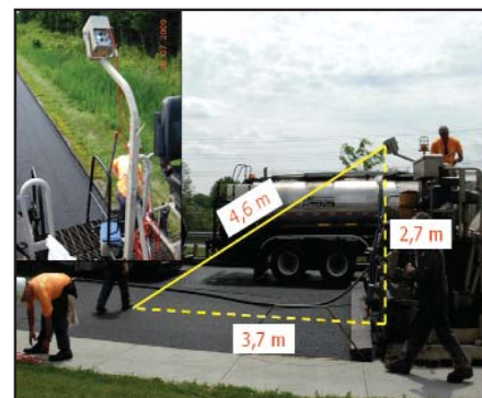
Figure 3 - Positionnement et zone de balayage du scanneur
