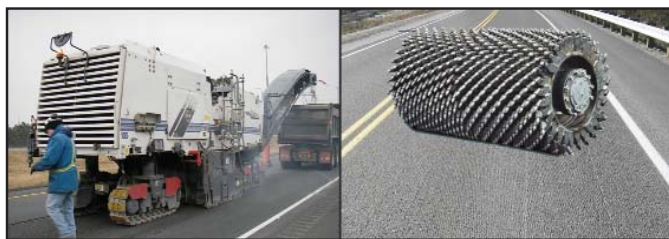
Figure 3 – Équipement et tambour de planage fin
