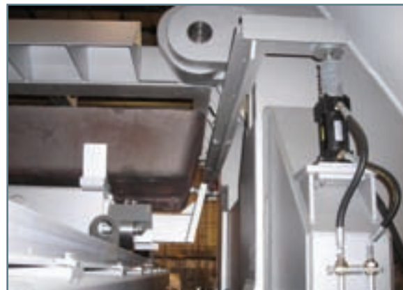
Le nouveau garde anti-éclaboussure qui sera installé sur le carrousel 201, le 21 novembre.
