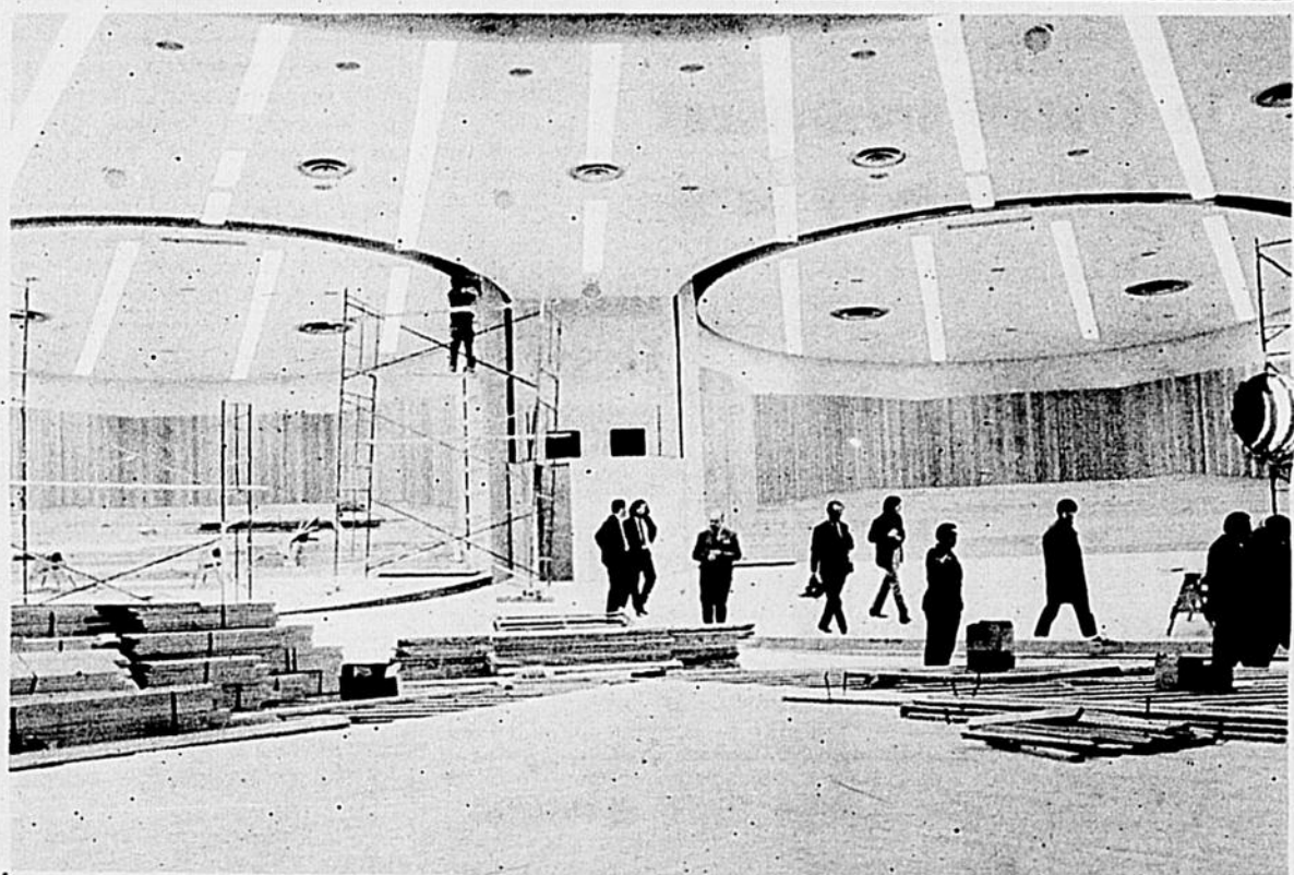
Des journalistes visitent l'auditorium de l'école Ozias Leduc. On remarquera les espaces circulaires au plafond qui permettront le glissement des murs des classes sphériques tournantes.
