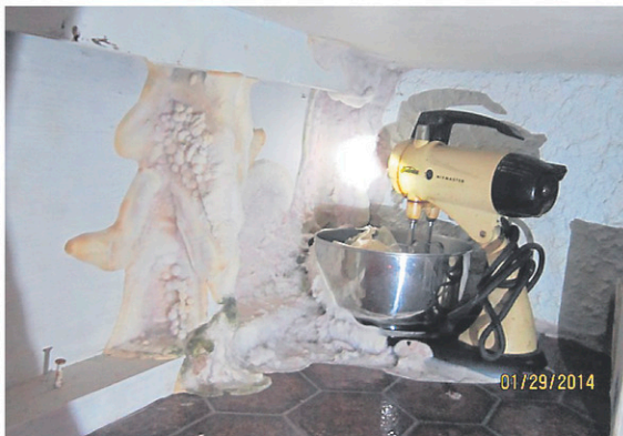
Cette image provient de l'un des pires cas que les techniciens de Sinisco ont répertoriés ces dernières années.
