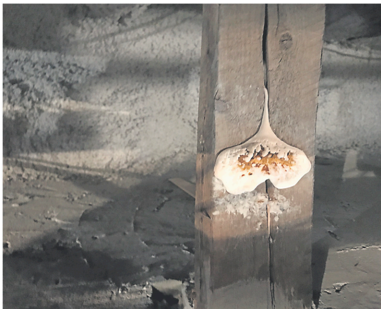
Un pied de la merle pleureuse sort d'une poutre dans le vide sanitaire d'une maison. — PHOTOS FOURNIES PAR SINISCO
